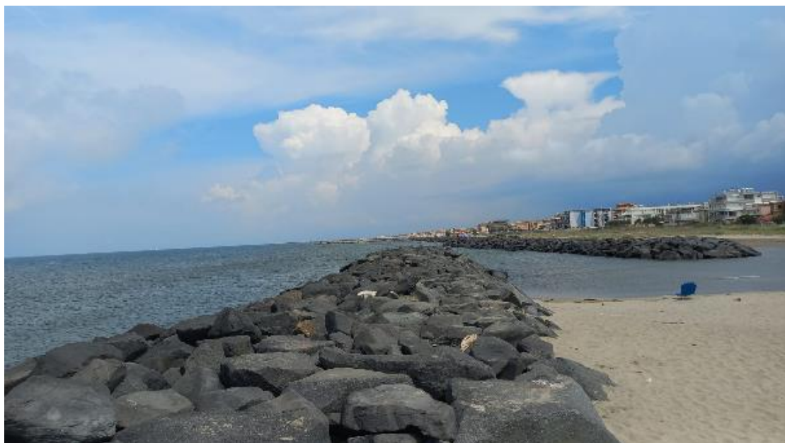
Figura 3.3 - Panoramica delle barriere antierosione
