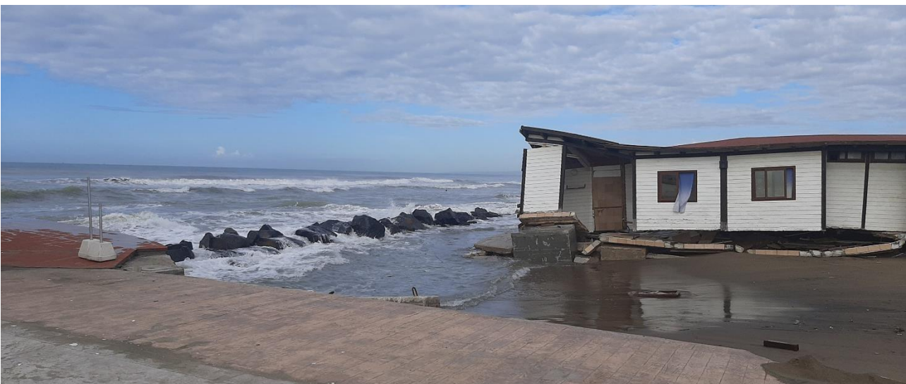
Figura 20 - Crollo delle cabine de La Nave a seguito delle mareggiate dell'inverno 2022; foto n. 1.
