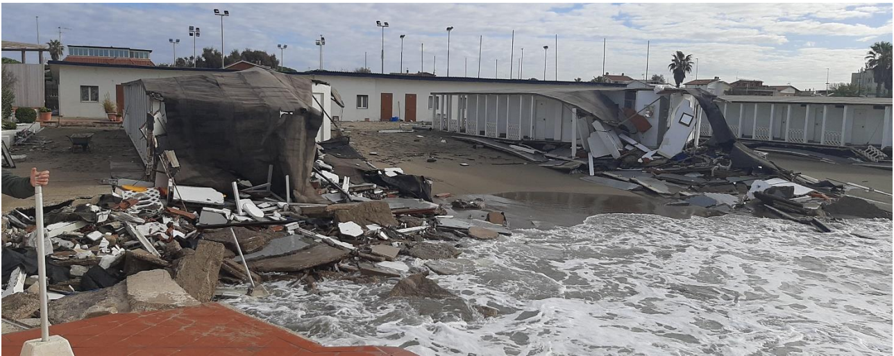
Figura 21 - Crollo delle cabine de La Nave a seguito delle mareggiate dell'inverno 2022; foto n. 2.
