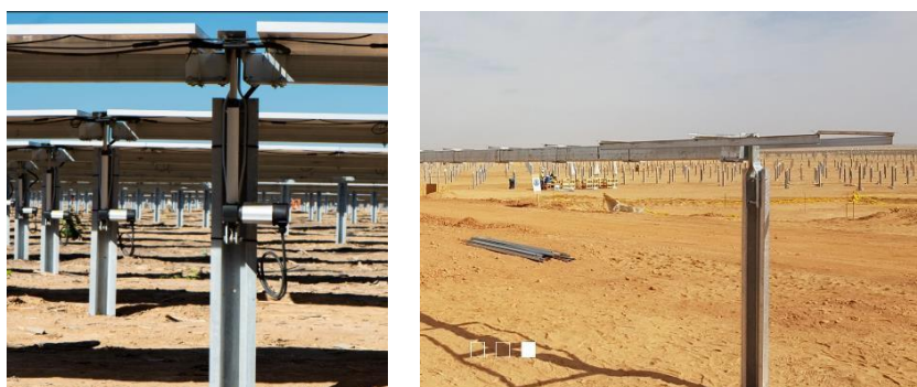
Figura 5 – Particolare strutture ad inseguimento ed attuatore
