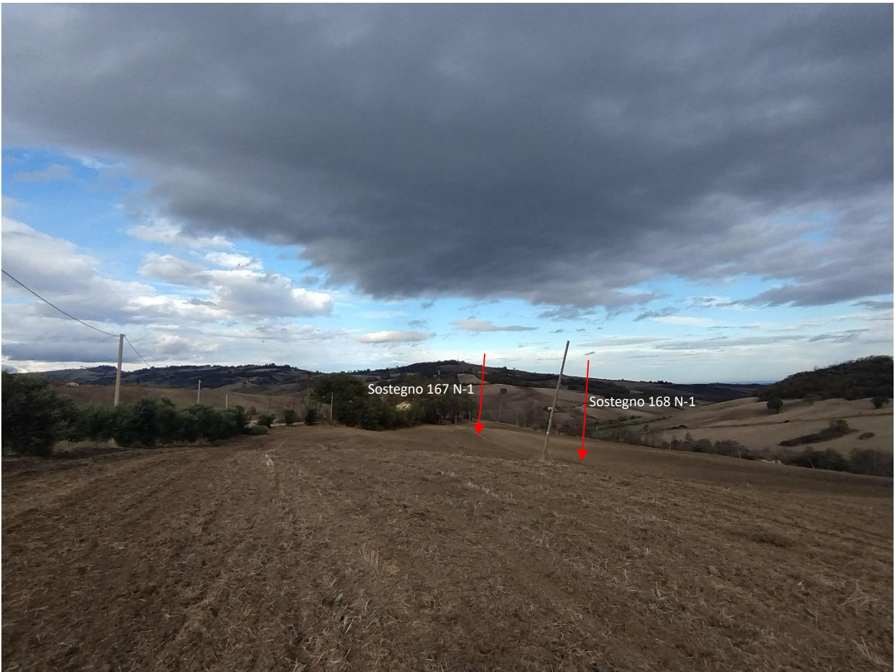
Foto 11: PV11 - Inquadramento con indicazione del posizionamento dei sostegni 167 N-1 e 168 N-1 su terreno agricolo e interferenza linea bT del passaggio dei raccordi a 380 kV (Coordinate: 483708.27 m E; 4639238.56 m N)
