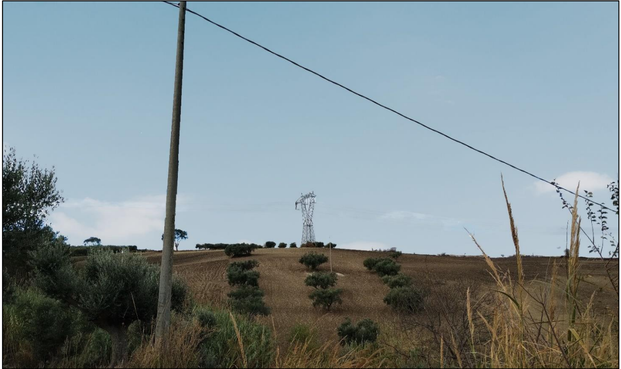
Figura 37 – PV5: Punto di ripresa in direzione dell'area prevista per la realizzazione del sostegno 167 N, con il sostegno 167 da demolire. Post – operam. (Coordinate: 483369.00 m E; 4639152.00 m N).
