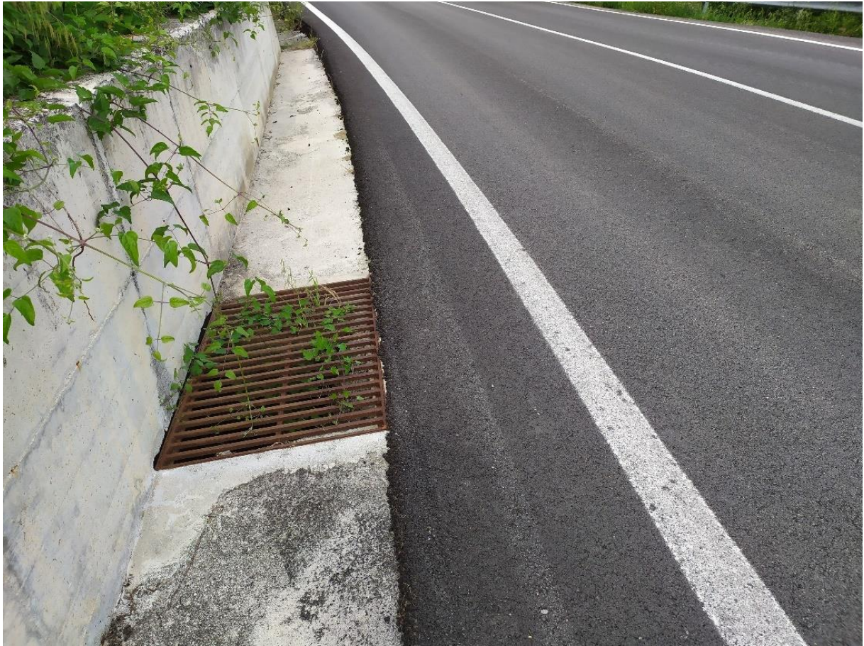
Figura 25. Canale di raccolta in corrispondenza della SS della Valle del Biferno.
