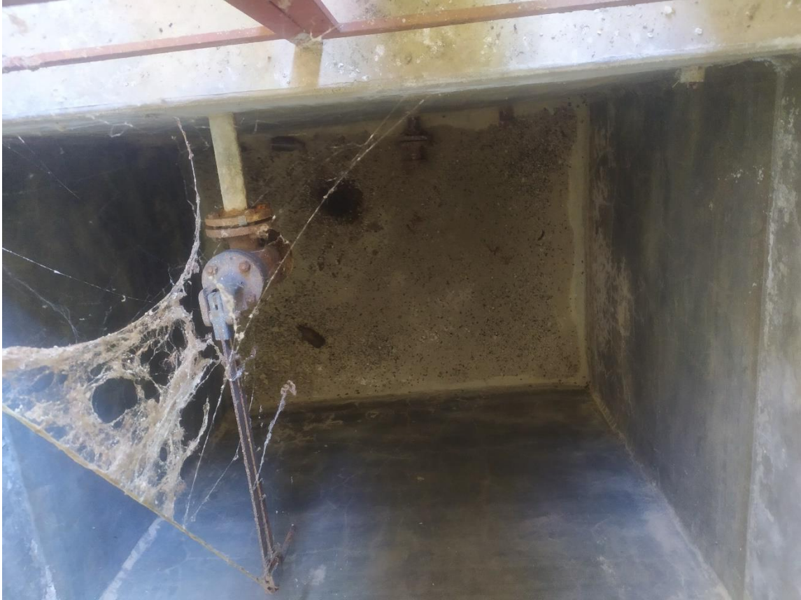
Figura 11. Interno della probabile camera di manovra dismessa
