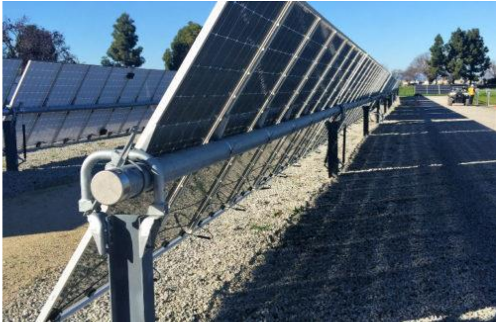
Figura 5.4 - Esempio di struttura di tipo mobile (tracker) monoassiale con configurazione 1p
