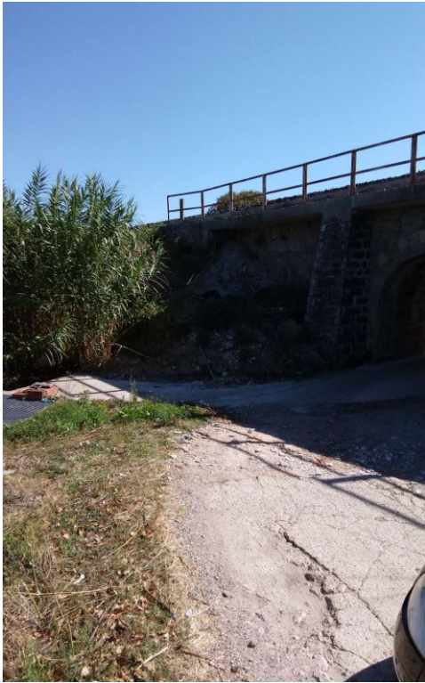
Figura s5.a: sottopassaggio ferrovia con rete fognaria
