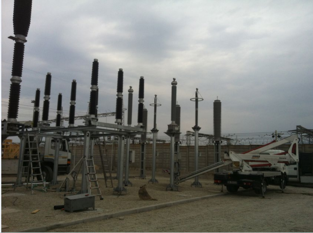
Fig. 18 – Foto tipo apparecchiature elettromeccaniche stallo AT.
