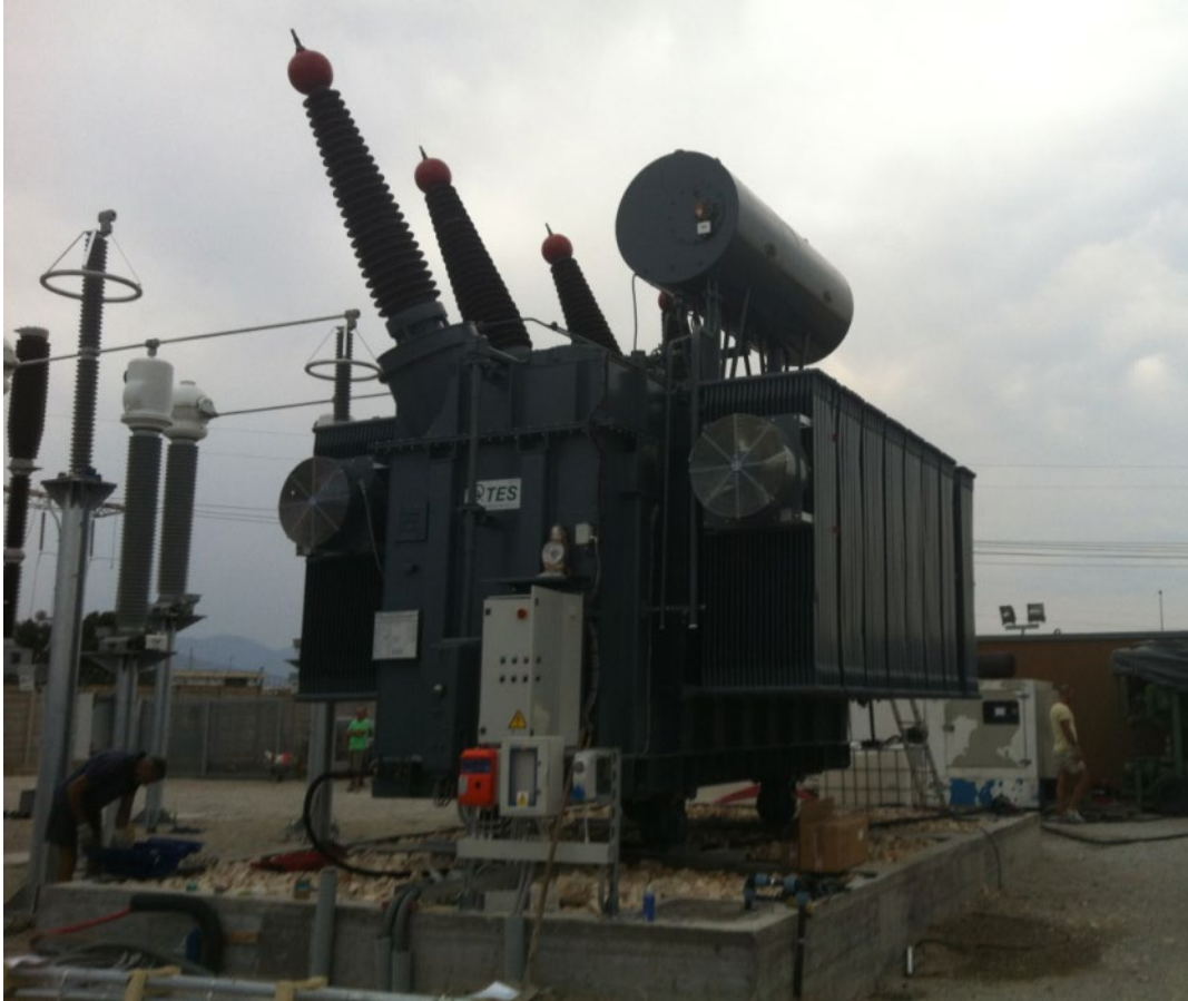
Fig. 17 – Foto trasformatore tipo.
