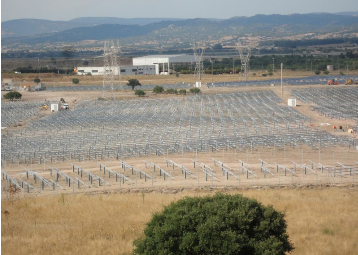
Fig. 14 – Foto tipo strutture di sostegno a terra.
