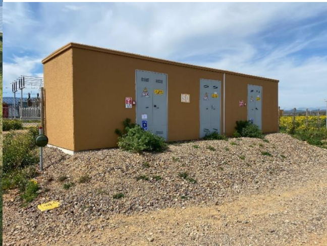
Figura 17: tipologia cabina inverter
