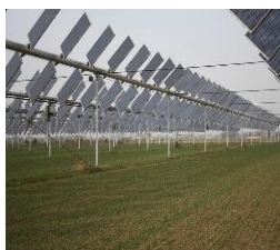
Impianti ad inseguimento biassiale su strutture elevate
