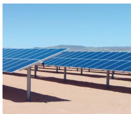
Impianto monoassiale (Inseguitore di rotlio)
