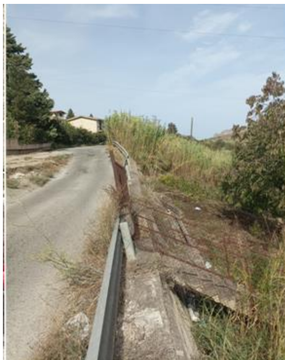
Figura 4-37: Particolare dei dissesti del versante nell'area del dissesto D29 bis
