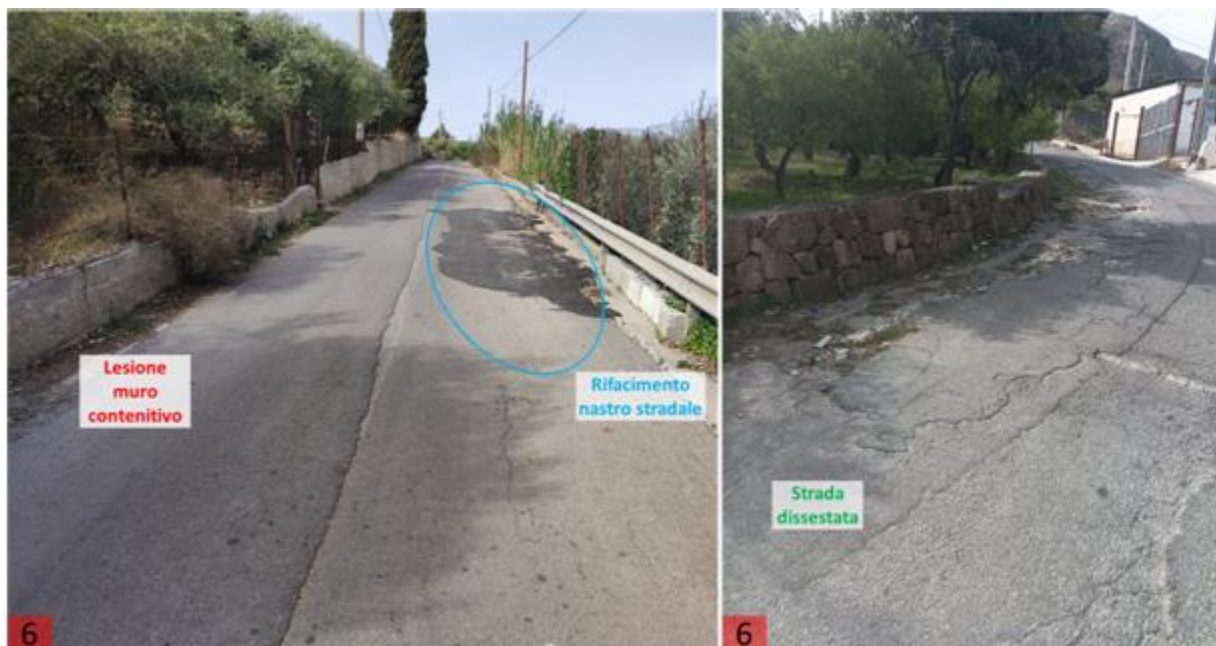
Figura 4-23bis: particolare del dissesto D20 nell'area di corona
