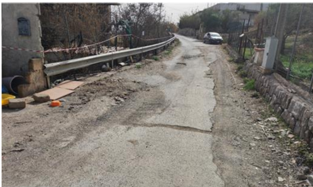
Figura 4-22: Particolare dei dissesti del versante nell'area del dissesto D17
