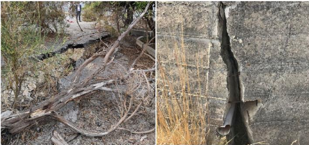
Figura 4-44: Particolare dei dissesti del versante nell'area del dissesto D38
