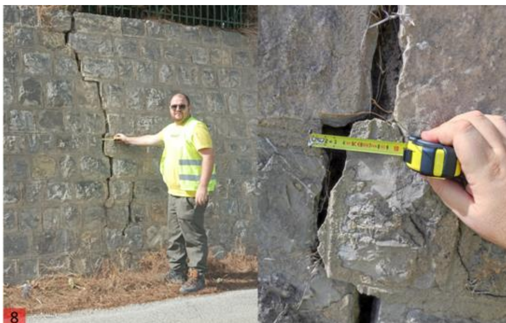
Figura 4-35: Particolare dei dissesti del versante nell'area del dissesto D29
