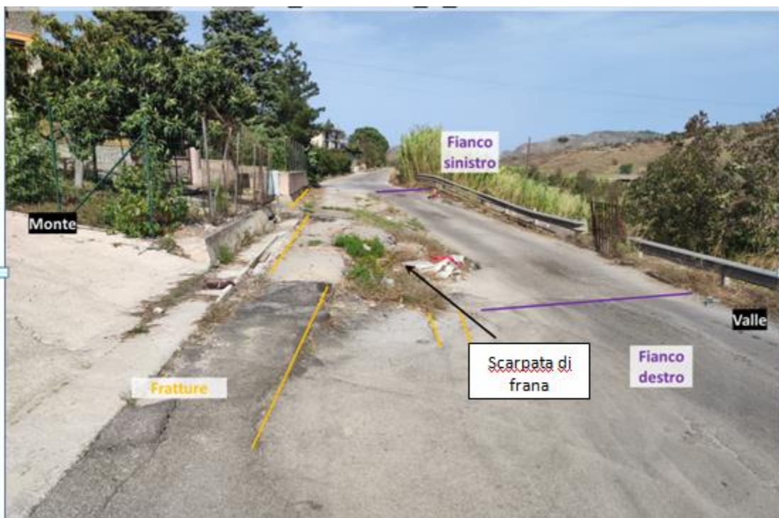
Figura 4-36: Particolare dei dissesti del versante nell'area del dissesto D29 bis
