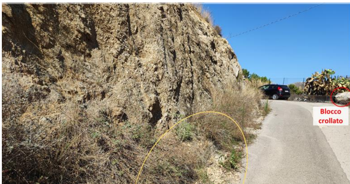
Figura 4-29: Particolare dei dissesti del versante nell'area del dissesto D25
