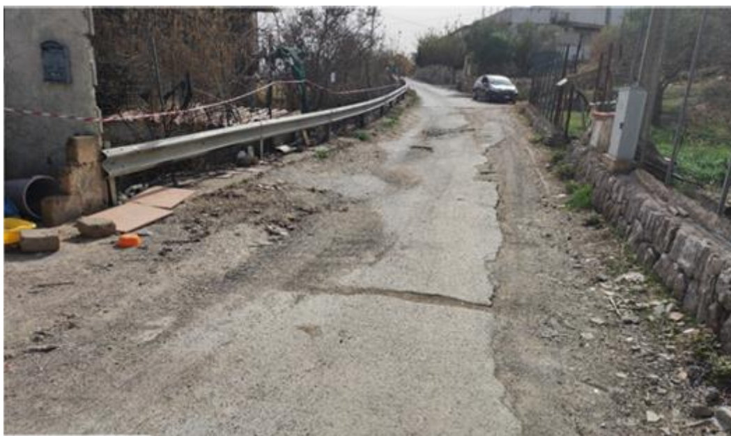
Figura 8-29: Particolare dei dissesti del versante nell'area del dissesto D17
