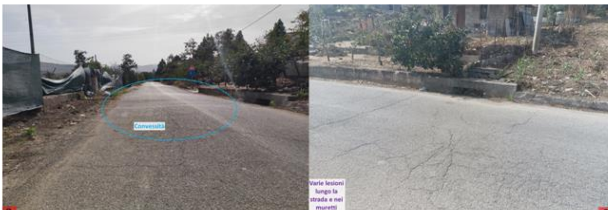
Figura 4-34: Particolare dei dissesti del versante nell'area del dissesto D29
