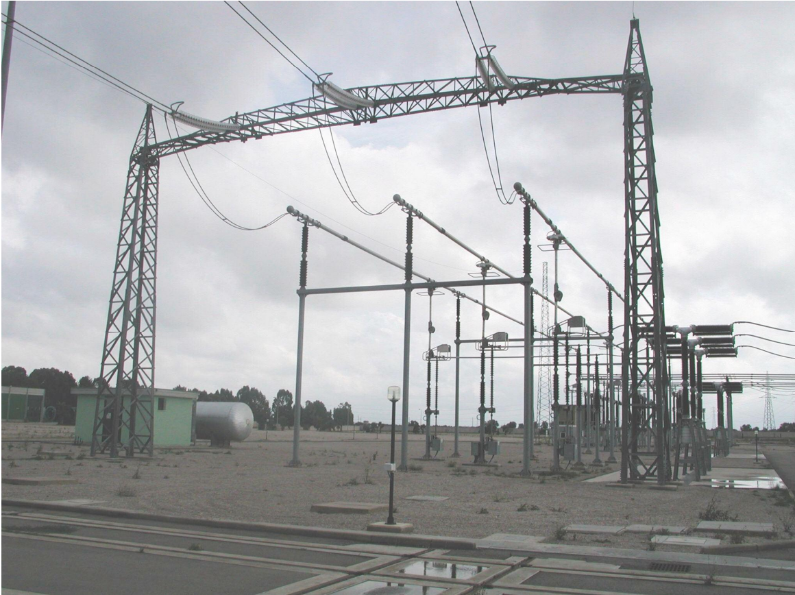
Foto 6 Montante AT 400 kV ca
