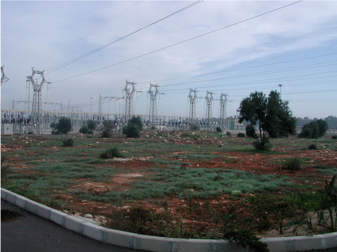
Foto 2 Stazione di trasformazione
