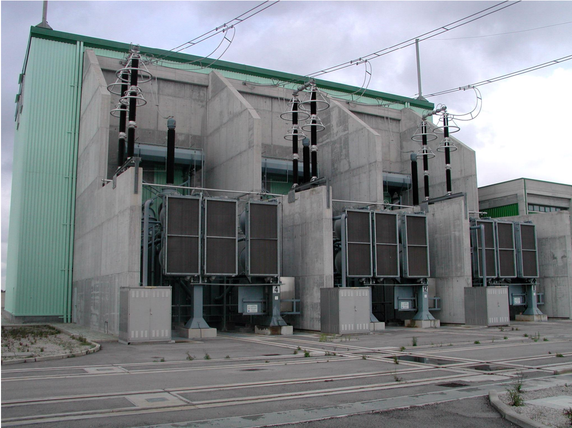
Foto 12 Trasformatori di conversione
