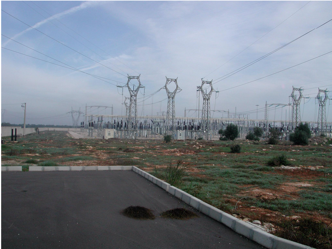
Foto 1 Stazione di trasformazione
