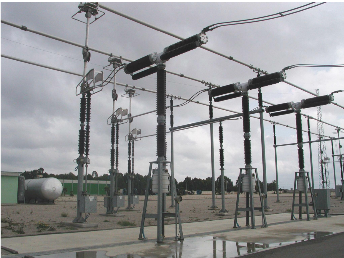
Foto 7 Stalli di alimentazione dei filtri armoniche
