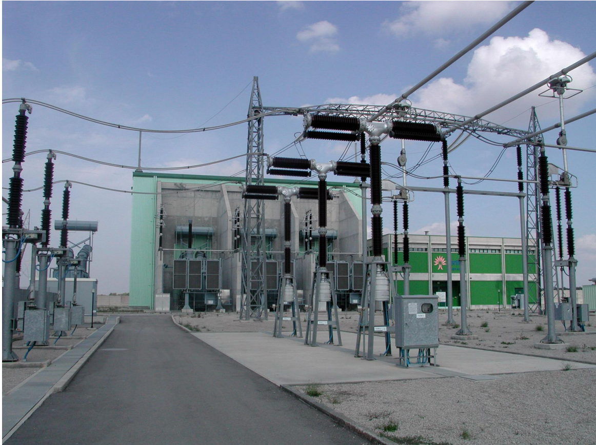
Foto 8 Stalli di alimentazione dei filtri armoniche
