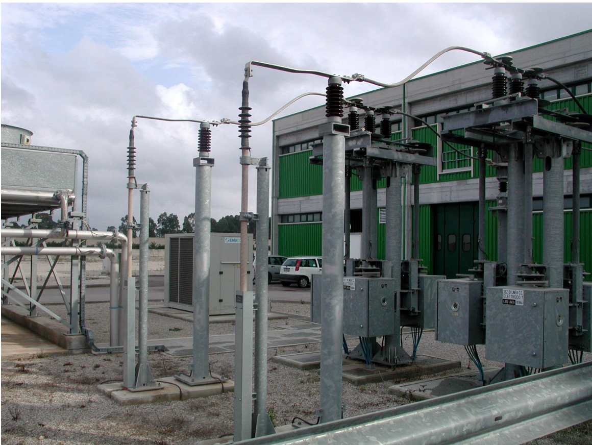
Foto 17 Montante AT 400 kVcc: particolare dei terminali di ritorno MT del cavo terrestre
