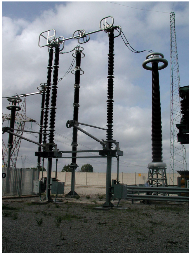
Foto 15 Montante AT 400 kVcc: sullo sfondo, il terminale AT del cavo terrestre
