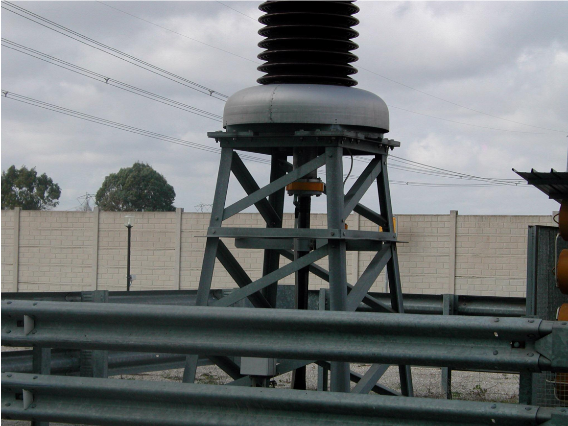
Foto 16 Montante AT 400 kVcc: particolare del terminale AT del cavo terrestre
