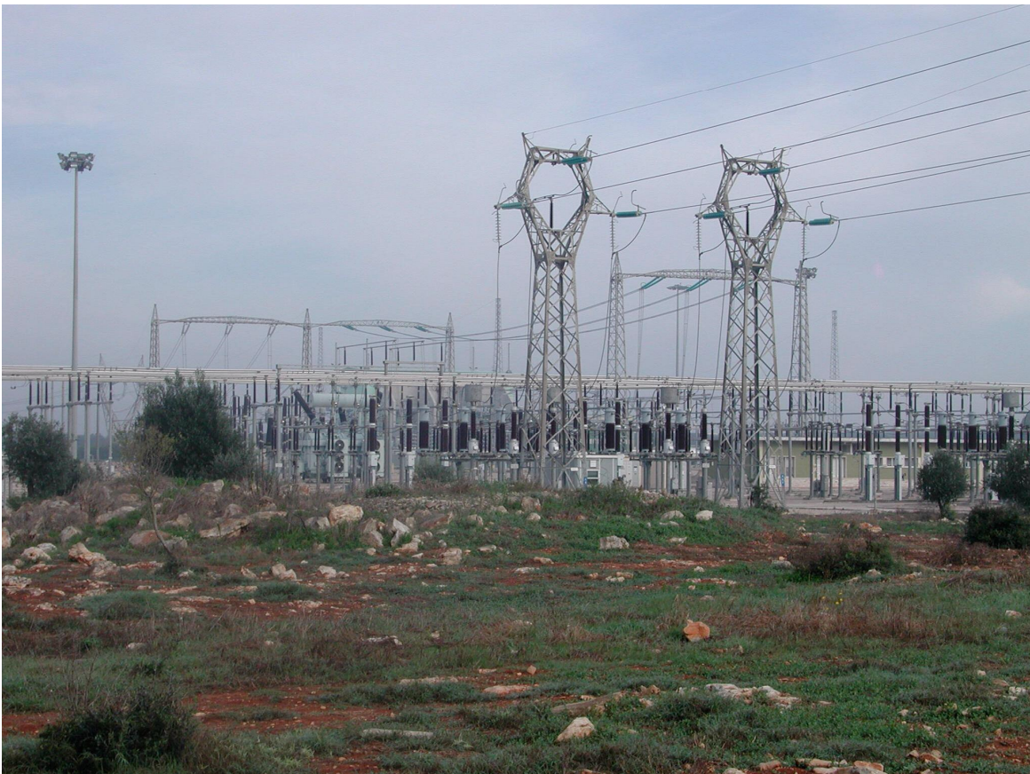
Foto 3 Stazione di trasformazione
