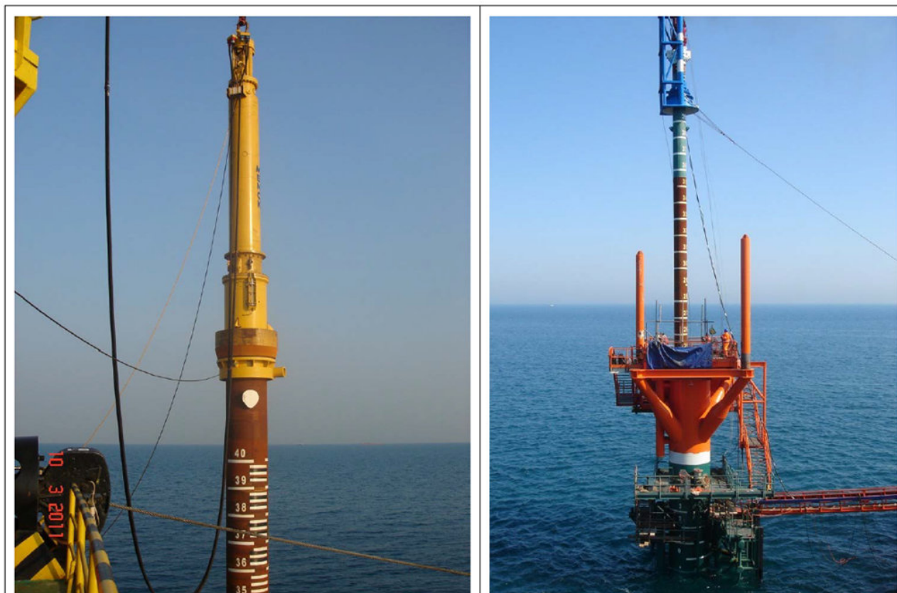
Figura 2-9: battipalo per infissione dei pali di fondazione (immagine a sinistra) e fase di battitura tubi guida
