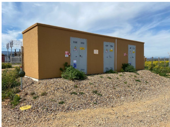
Immagine 3.2: tipologia cabina inverter
