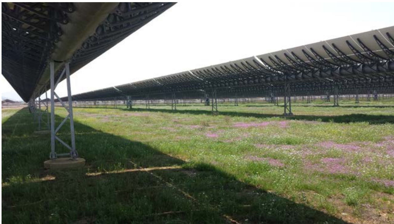
Figura 14: immagine ripresa presso l'impianto solare termodinamico di Extresol 3 in Spagna
