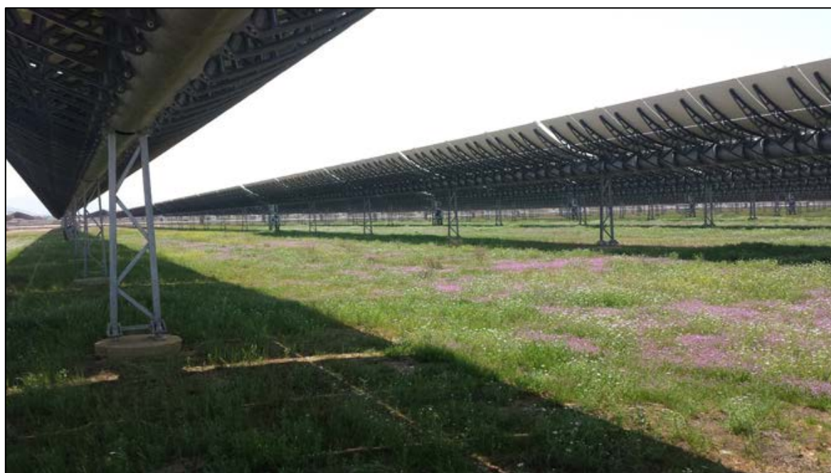
Figura 21: Strato erboso naturale all'interno di un campo solare termodinamico (centrale spagnola Extrasol 1-2-3)
