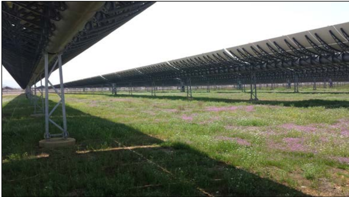
Figura 9: Impianto solare termodinamico Extresol 1-2-3
