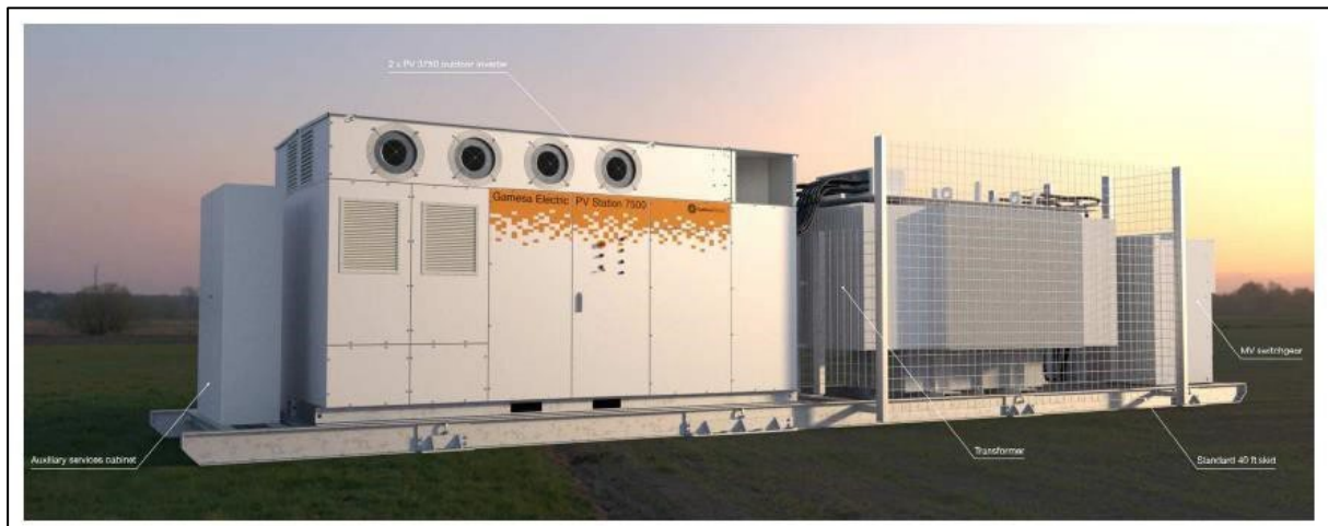
Figura 9 - ESEMPIO DI CABINA ELETTRICA (POWER STATION)
