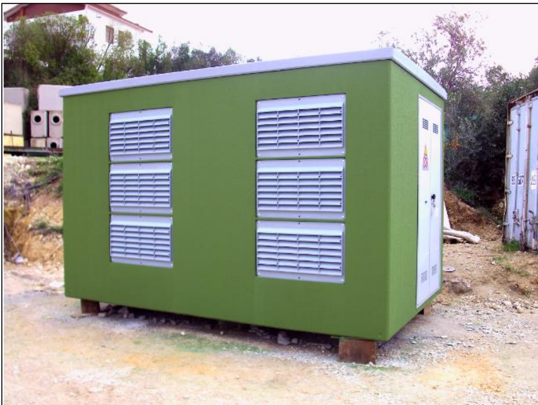
Tipico cabina elettrica prefabbricata
