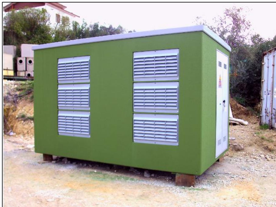
Tipico cabina elettrica prefabbricata
