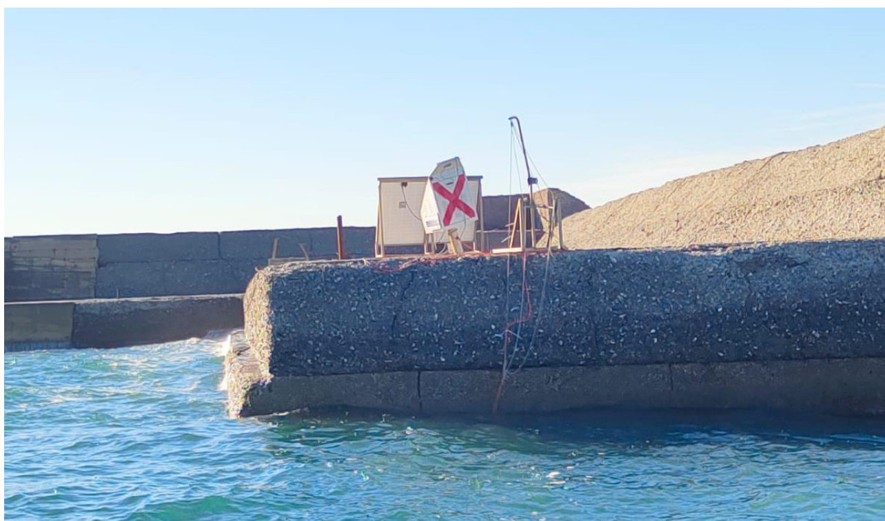
Stazione fissa FM danneggiata dalla mareggiata del 3 Novembre.
