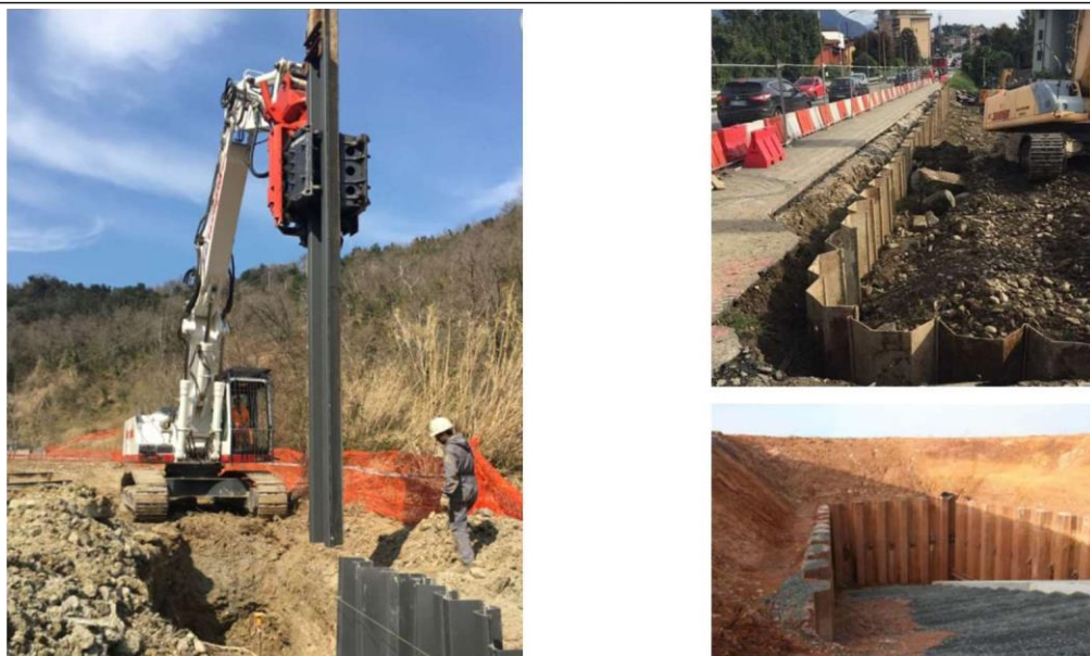
Figura 5 – Scavi a sezione obbligata. Esempi di protezione del fronte di scavo con palancole
