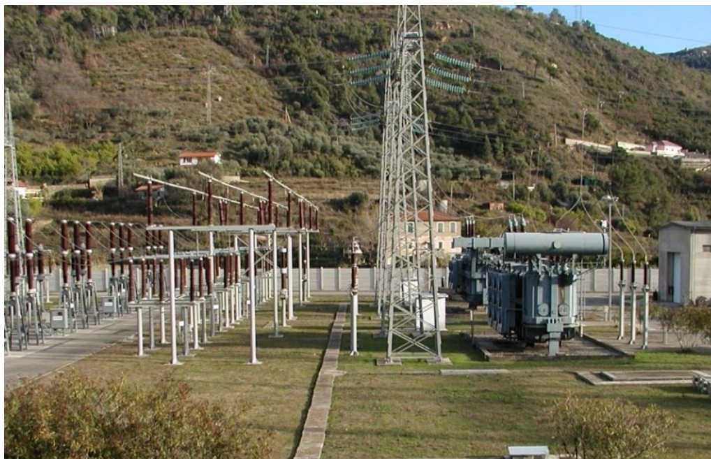
Figura 1.2: Esempio di sottostazione di trasformazione
