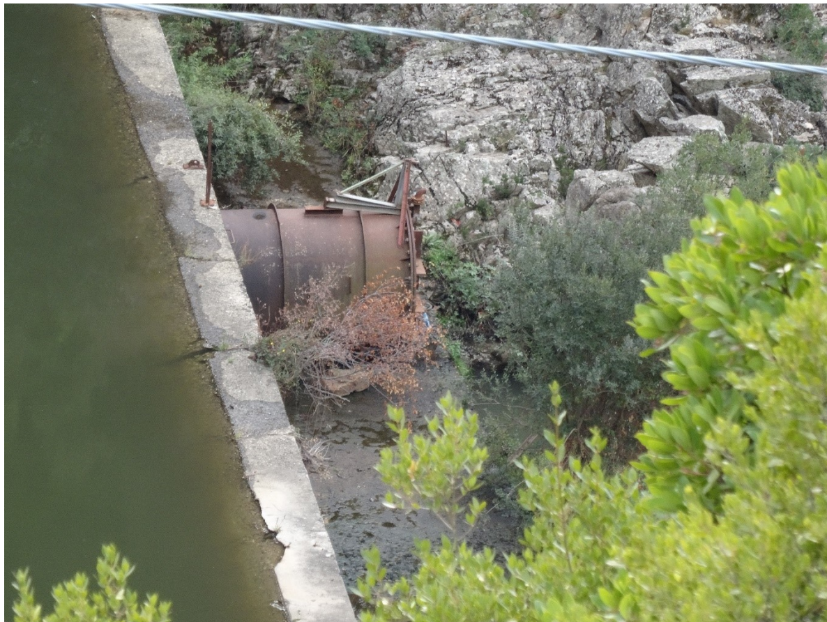
Flangia cieca fissata sullo sbocco di valle dello scarico di fondo sinistro per il fuori servizio (dal 2013).
