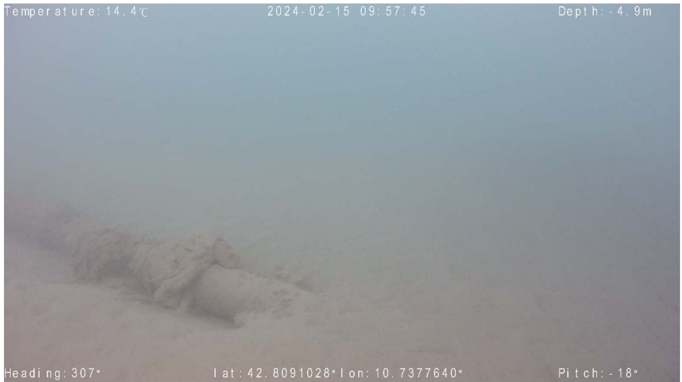
Figura 32- transetto 14: Porzione di tubazione adagiata sul fondo.
