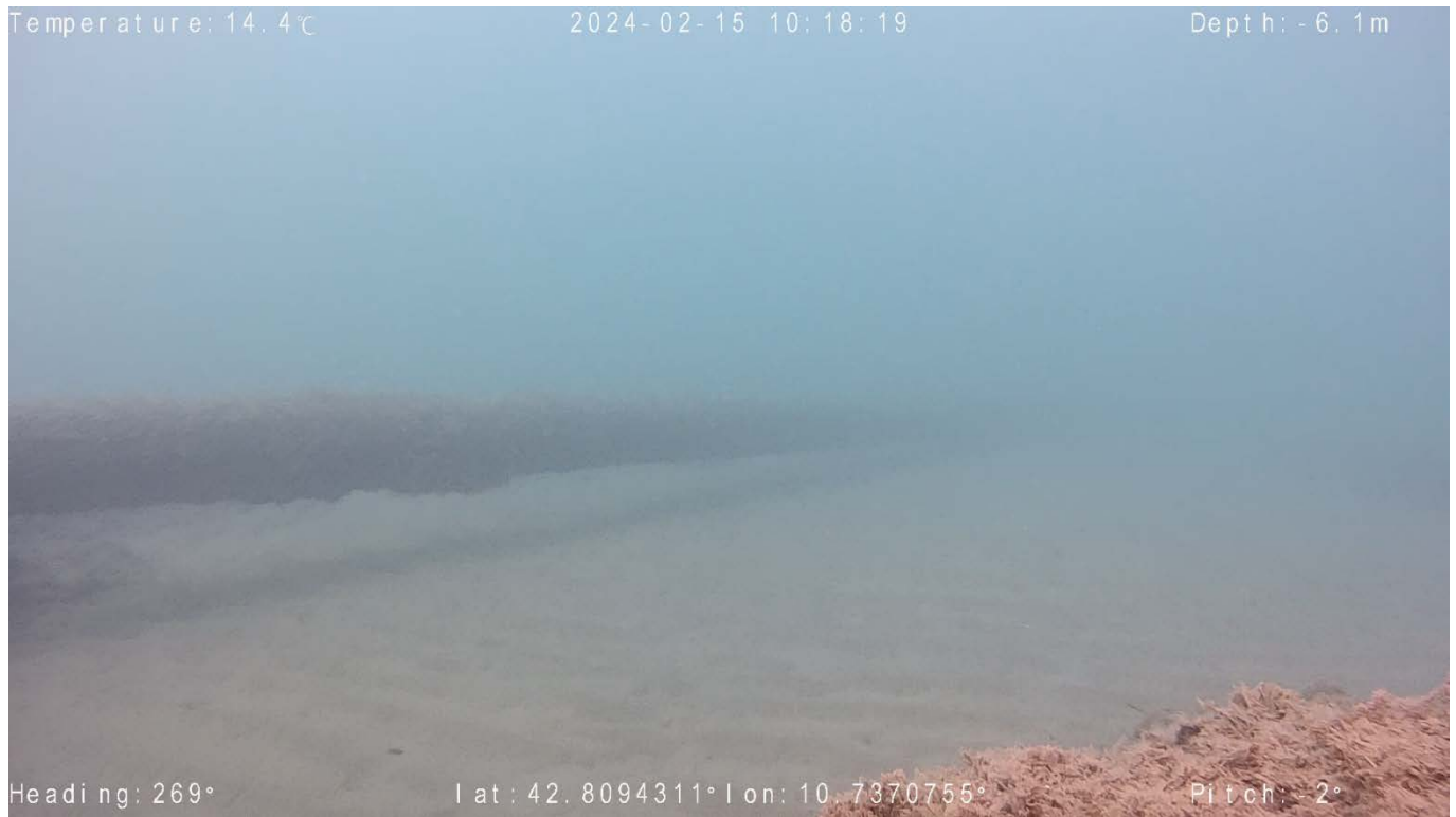
Figura 33- transetto 15: Particolare tubazione sollevata dal fondo
