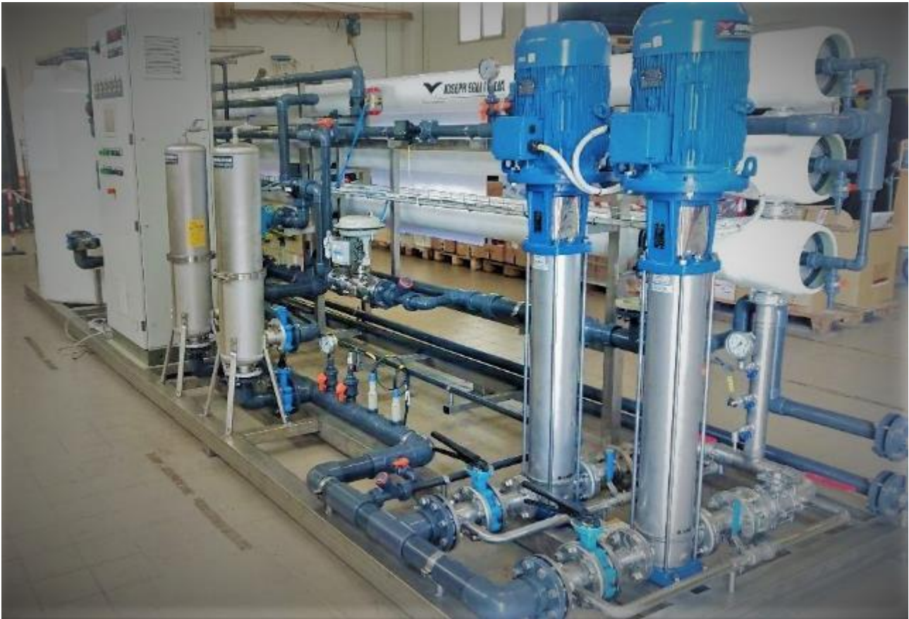
Figura 2 Impianto di Osmosi Inversa
