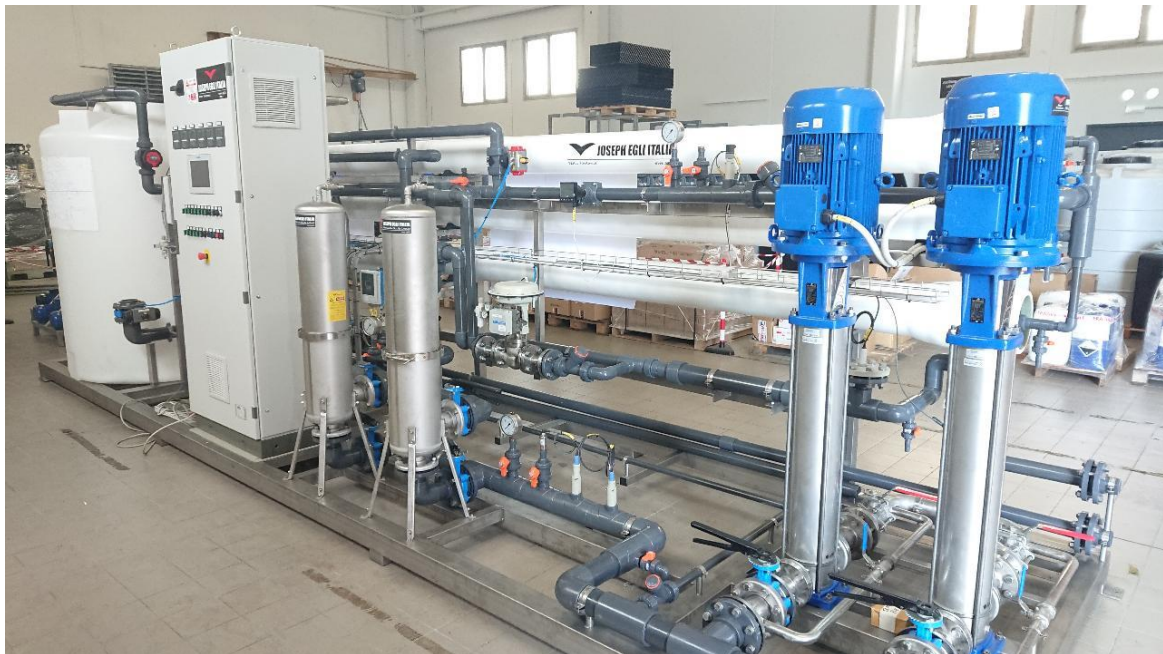
Immagine: 1: esempio di realizzazione impianto Osmosi Inversa (sito Altavilla Vic.na)
