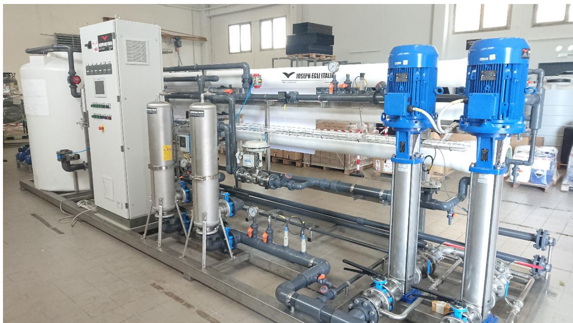
Immagine: 1: esempio di realizzazione impianto Osmosi Inversa (sito Altavilla Vic.na)
