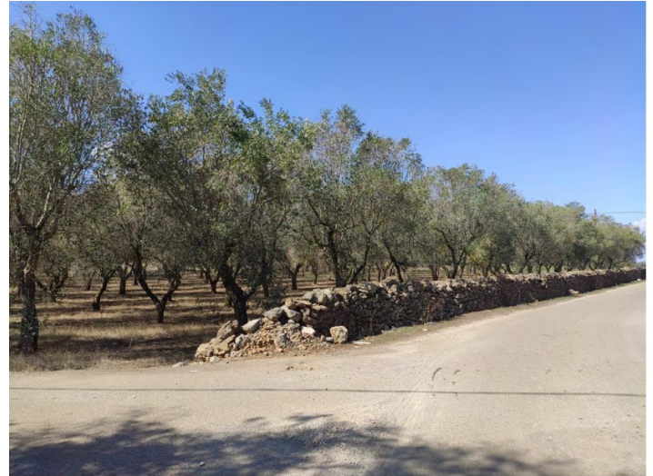
Fig.43 - Tratto di muro a secco oggetto di demolizione e ricostruzione. Strada di accesso alla MES08 dalla SP69. Lunghezza 30ml di muro a secco da demolire e ricostruire.
