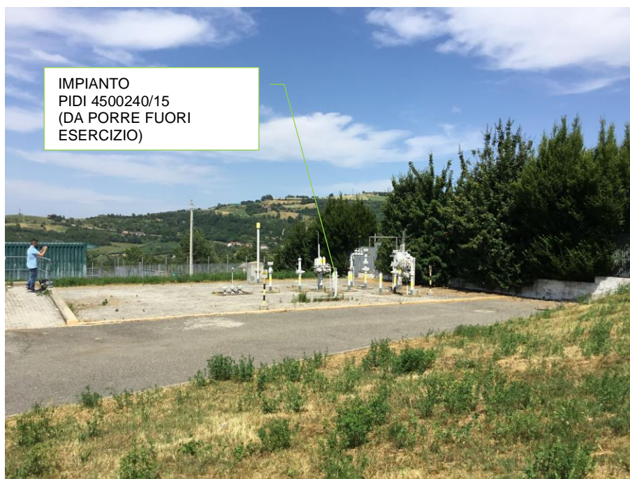
Foto n.6 – Panoramica impianto P.I.D.I 4500240/15 Esistente (interno all'impianto di Ponti)
