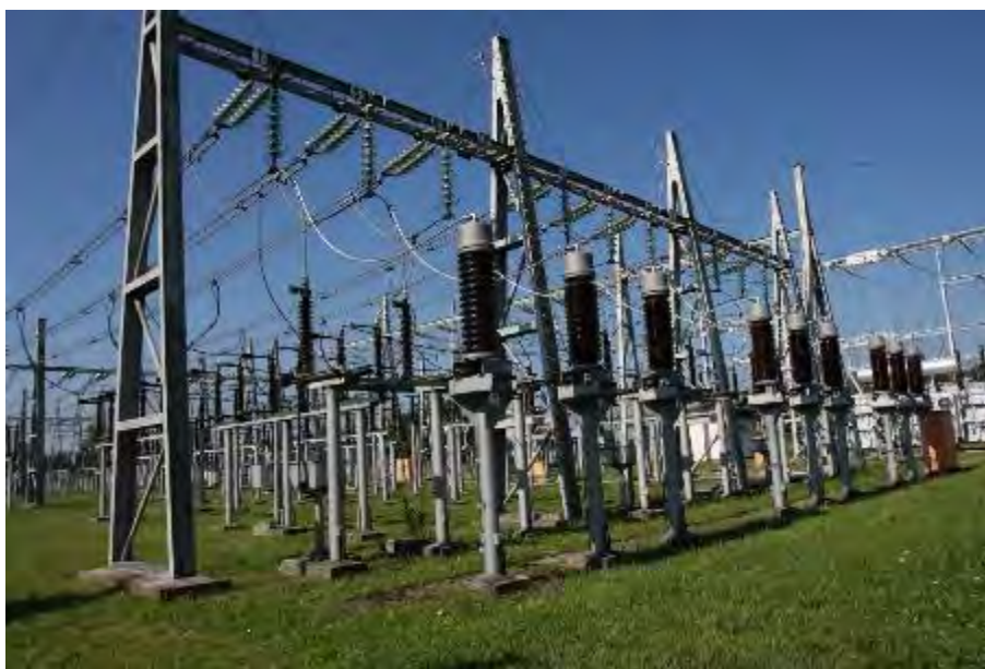
Figura 202 – Esempio sottostazione di transizione, portale linea aerea
