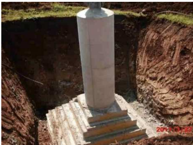
Figura 7.101 – Fondazioni superficiali tipo CR e colonnino di raccordo con la base del sostegno.
