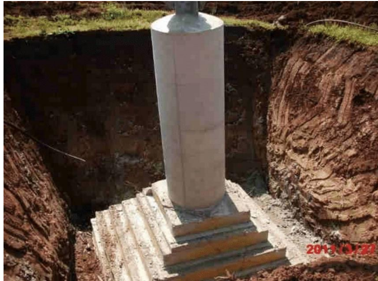
Figura 4.12 – Fondazioni superficiali tipo CR e colonnino di raccordo con la base del sostegno.
