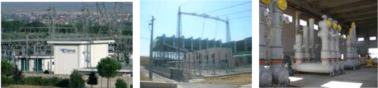
Figura 2.3 – Stazione isolata in aria (sinistra) e stazione blindata (esterno e interno).
