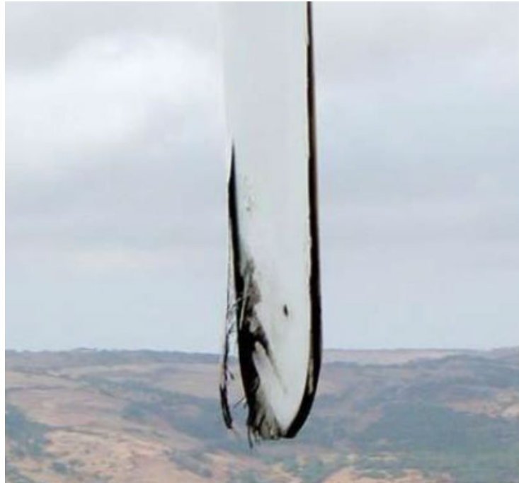
Figura 2 - Estremità della pala danneggiata da fulminazione atmosferica
