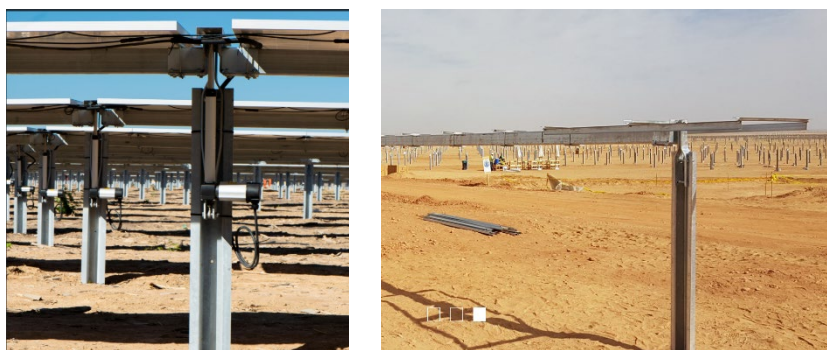
Figura 6 - Particolare strutture ad inseguimento ed attuatore
