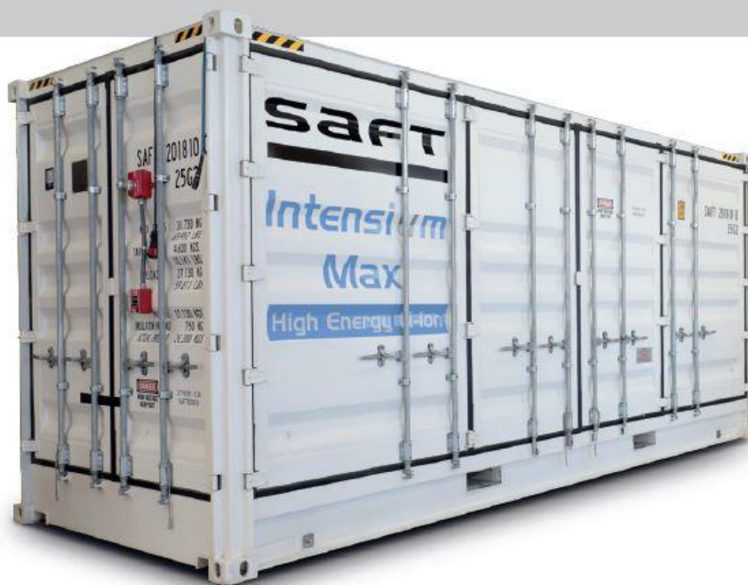
Figura 5 – Esempio container di accumulo del tipo 20ft e capacità 2,3 MWh
