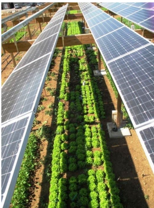
Figura 19 – Immagine di un impianto sperimentale Agro-Fotovoltaico
