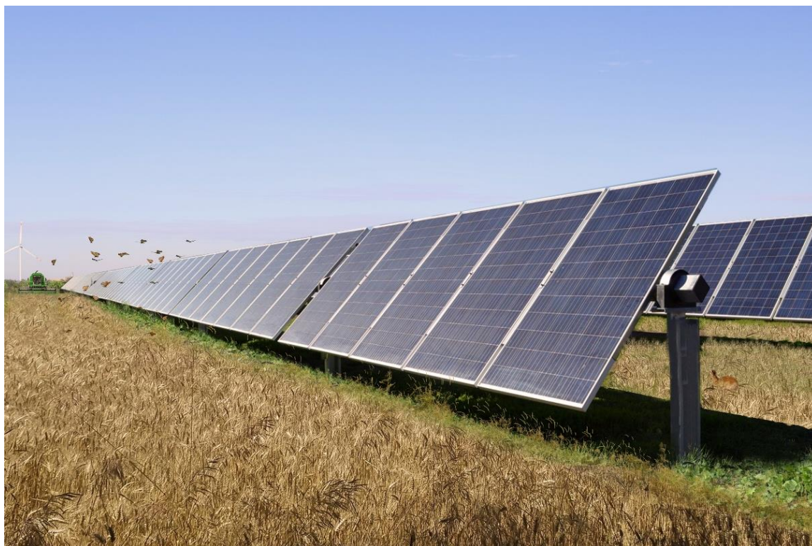
Figura 37:Grano tra le file dei pannelli fotovoltaici
