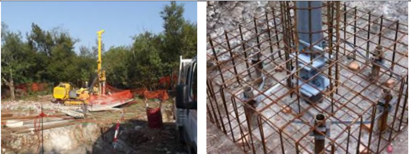
Figura 11 - Esempio di realizzazione di una fondazione su micropali tipo tubfix. Nell'immagine di destra si può notare il particolare del raccordo tra i tubolari metallici dei micropali con l'armatura del plinto di fondazione; al centro del plinto si nota il moncone del sostegno (elemento di raccordo tra il sostegno e la fondazione) il quale viene annegato nella fondazione stessa
