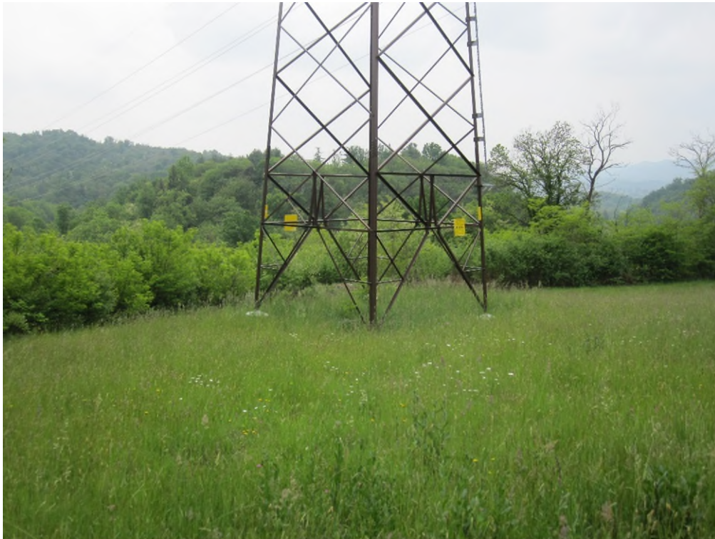
Figura 28 - Intervento di inerbimento sulle linee 132 kV della Val D'Ossola Sud
