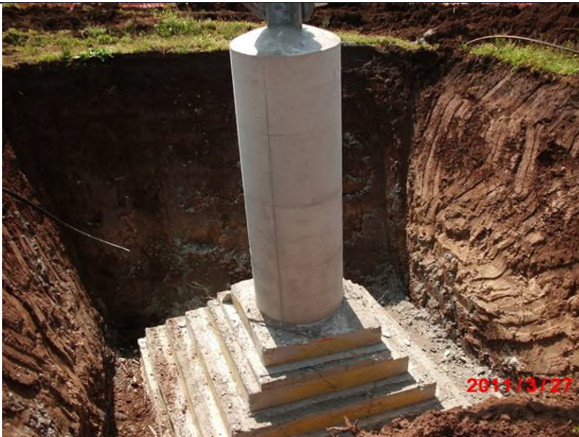
Figura 8 - Realizzazione di fondazioni superficiali tipo CR per un sostegno a traliccio. Nell'immagine si può osservare una fondazione CR appena "scasserata". Si possono distinguere facilmente la parte inferiore a parallelepipedi tronco piramidali ed il colonnino di raccordo con la "base" del sostegno
