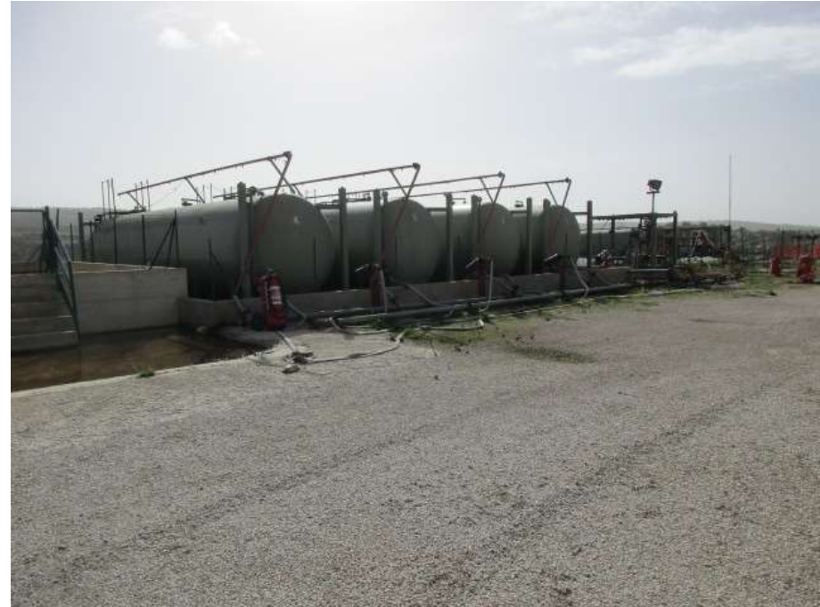
Cono 16 – Serbatoi di stoccaggio olio greggio
