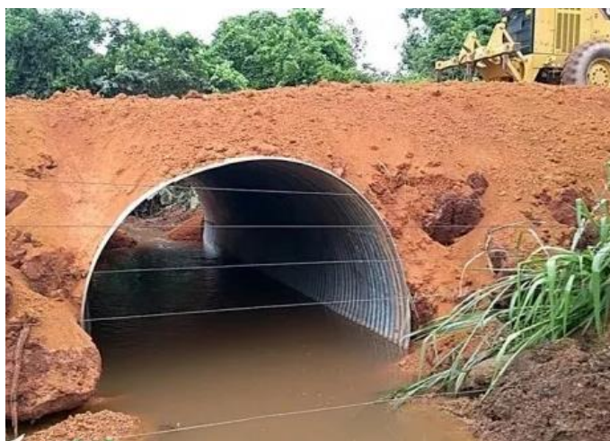
Figura 4-8. Immagine a carattere illustrativo di un tubo di tipo ARMCO ricoperto
