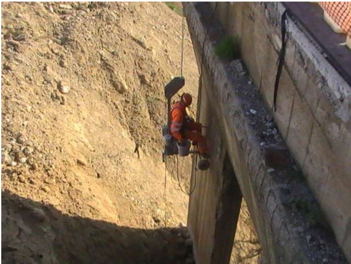
Foto 38. a. e “b”. Perforazione fori da mina sulle stilate, da navicella sospesa, vincolata ad una trave zavorrata posta sull'impalcato (foto “a”). Mediante questo sistema è possibile perforare le stilate a qualsiasi altezza, anche sull'arco, la dove l'utilizzo di piattaforme aeree non sarebbe possibile per la impassibilità di stazionamento sul sedime. La perforazione è effettuata con martelli elettrici a rotopercussione o pneumatici.
