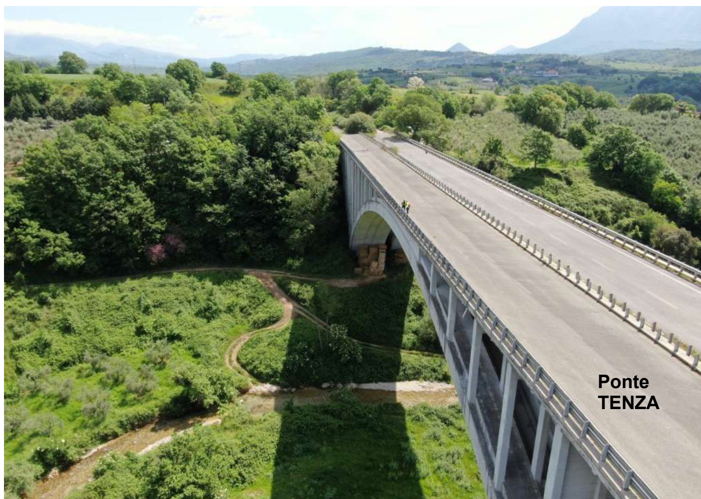
Foto 20.a (sopra) Soletta, arco scatolare e pile a doppia stilata connesse da un muro, e foto "b" impalcato-cordolo ed arco. Nella foto b. sono evidenti gli interventi di consolidamento dell'arco effettuati negli anni 90.
