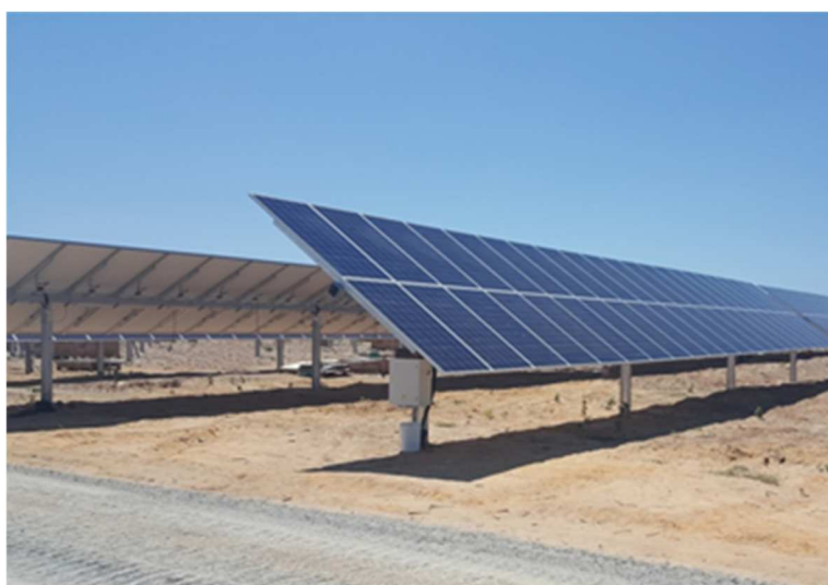
Figura 4 - Particolare strutture di sostegno del tipo ad inseguimento monoassiale
