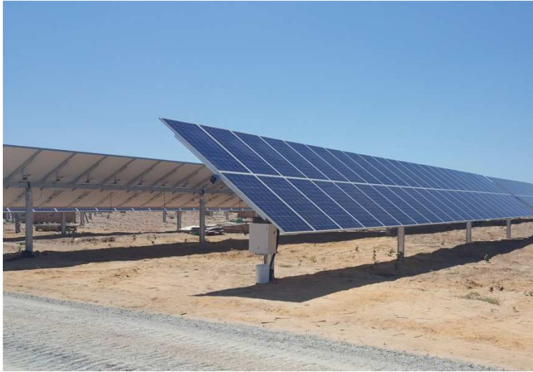
Figura 2 - Particolare strutture di sostegno impianto del tipo ad inseguimento monoassiale
