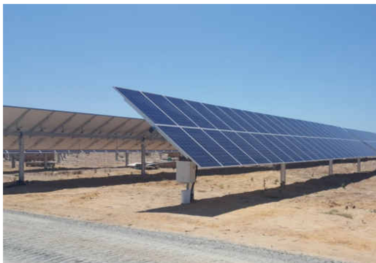
Figura 17 - Particolare strutture di sostegno impianto del tipo ad inseguimento monoassiale
