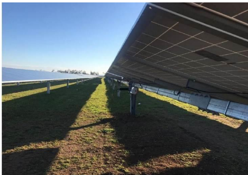
Figura 4.1.2 - Esempio di impianto fotovoltaico realizzato con supporti costituiti da pali in acciaio infissi direttamente nel terreno. Gli impatti sul suolo sottostante risultano essere minimizzati.
