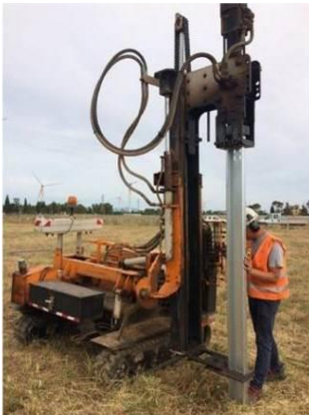
Figura 4.1.1 - Esempio di supporto costituito da palo in acciaio infisso direttamente nel terreno mediante battipalo.
