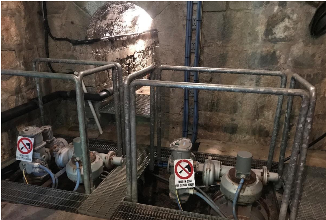
Figura 3-17 Camera di manovra
