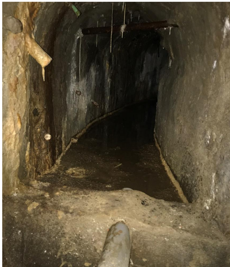
Figura 3-18 Galleria di drenaggio
