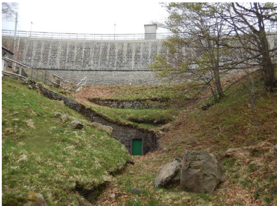
Figura 6 – Vista del paramento di valle nella zona prossima alla sponda orografica sinistra
