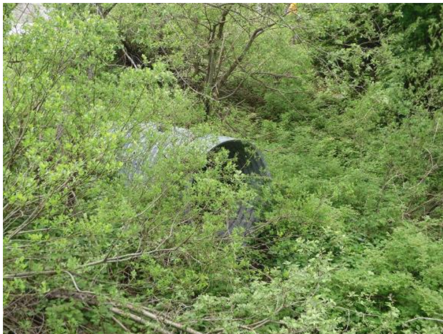
Figura 14 – Tubazione corrugata sbocco dello scarico di superficie
