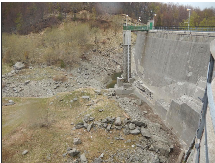
Figura 2–18: parametro di monte –sponda sinistra: dettaglio piede della diga (fonte: Relazione fotografica progetto)
