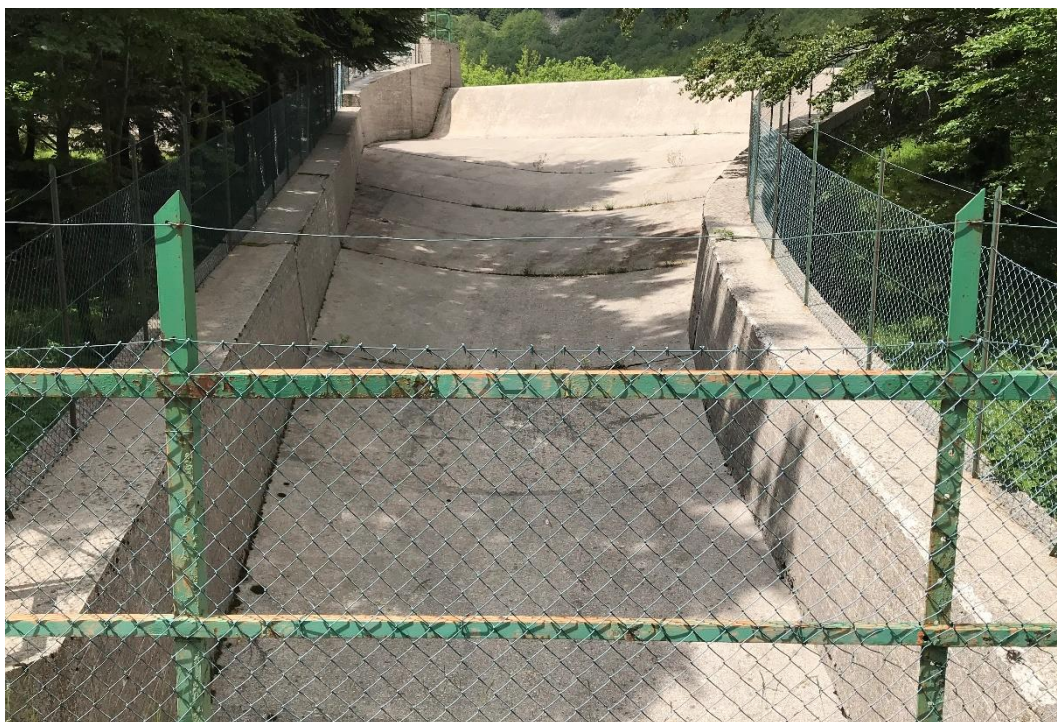
Figura 4-13 In alto la soglia dello scarico di superficie. In basso il canale fuggatore dello scarico di superficie
