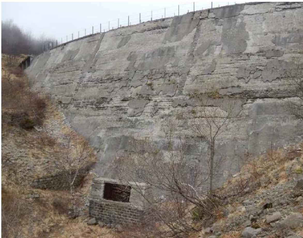
Figura 5-14 – Stato del paramento di monte
